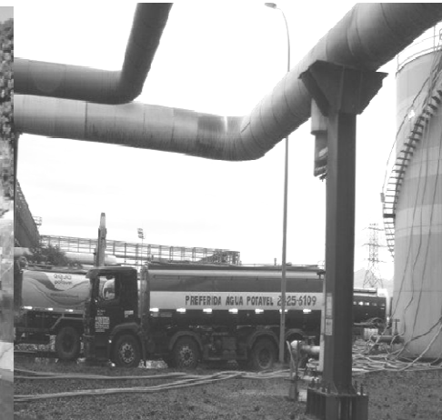
Suprimento de água potável para planta de Desmineralização e rede de água potável
