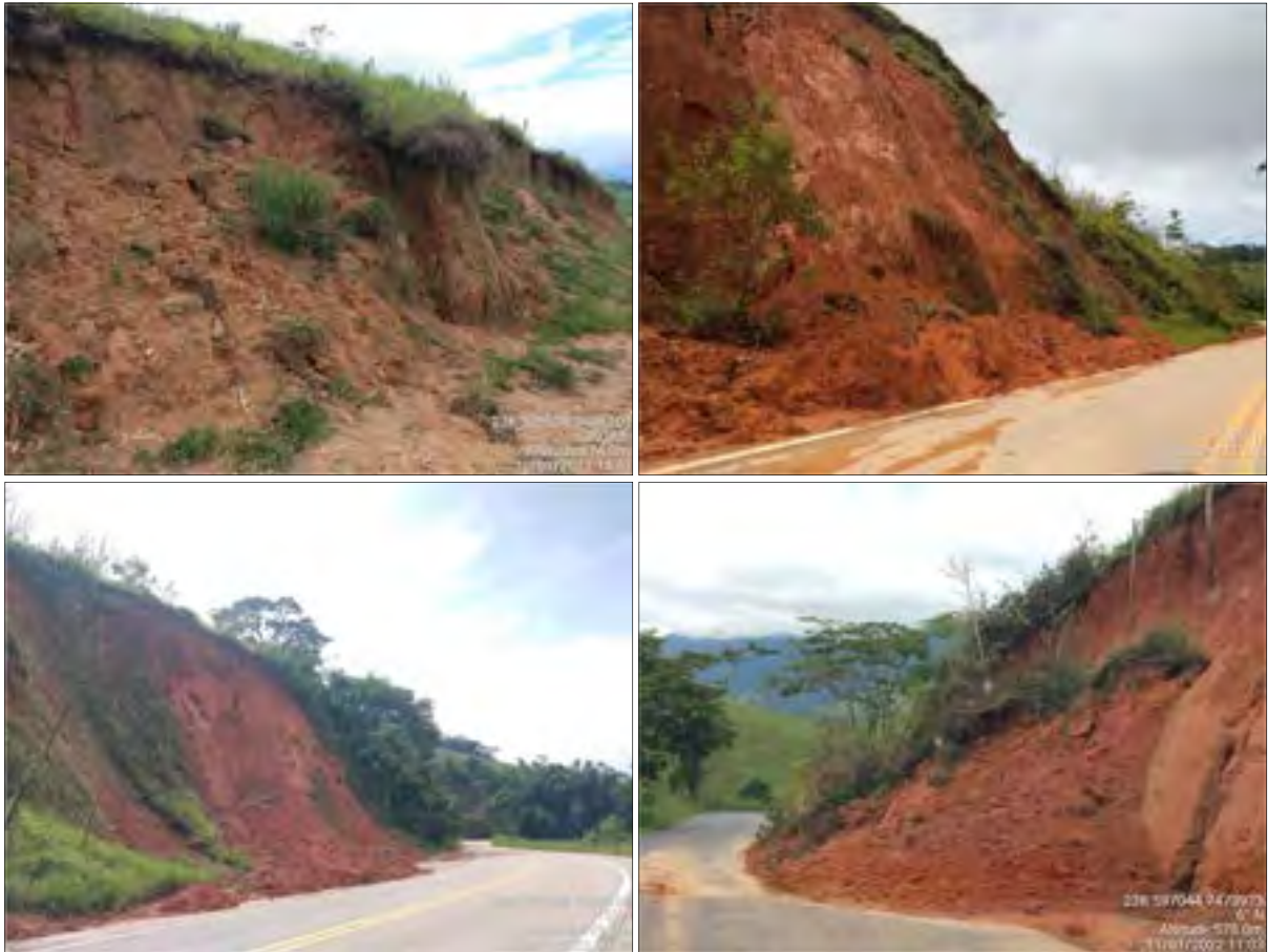
Foto 9. Registros de campo de queda de barreiras observadas no município de Rio Claro/RJ.
