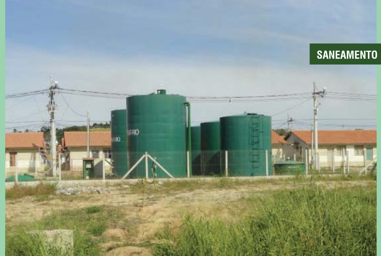
Estação compacta trata os esgotos dos condomínios populares Parque das Flores (315 casas) e Jardim das Acácias (325 casas) em Seropédica (RJ).
