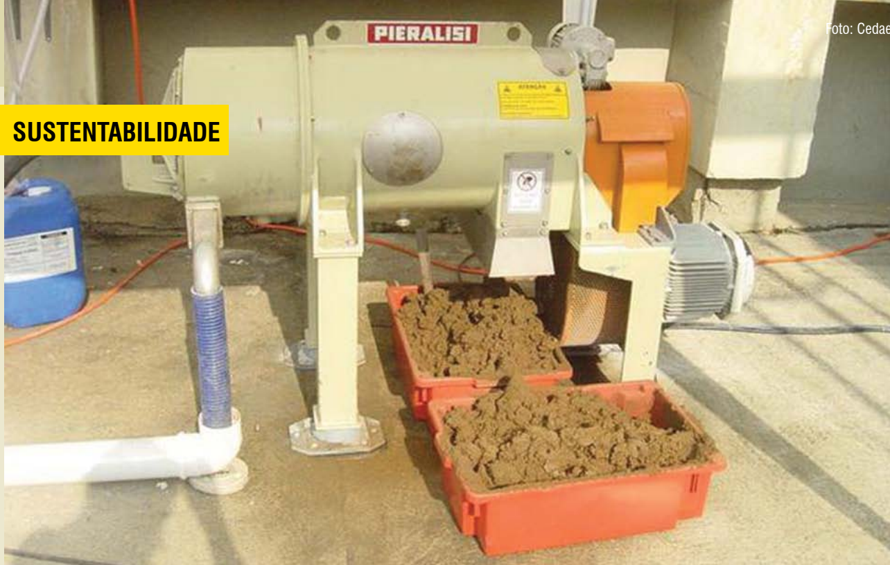
Esta centrífuga retira o máximo de água do lodo
