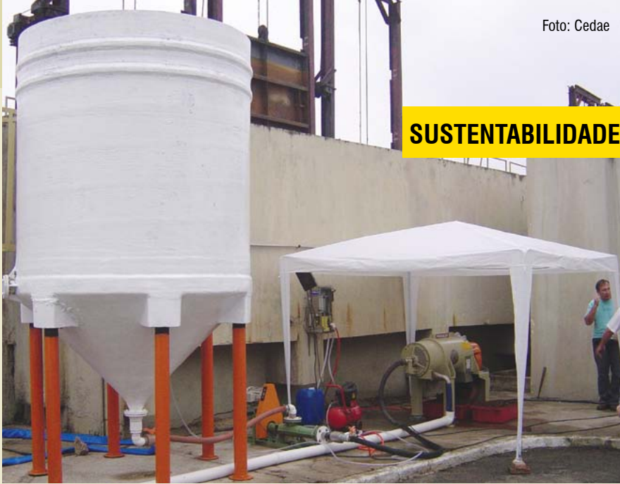
O lodo é bombeado para este tanque adensador
