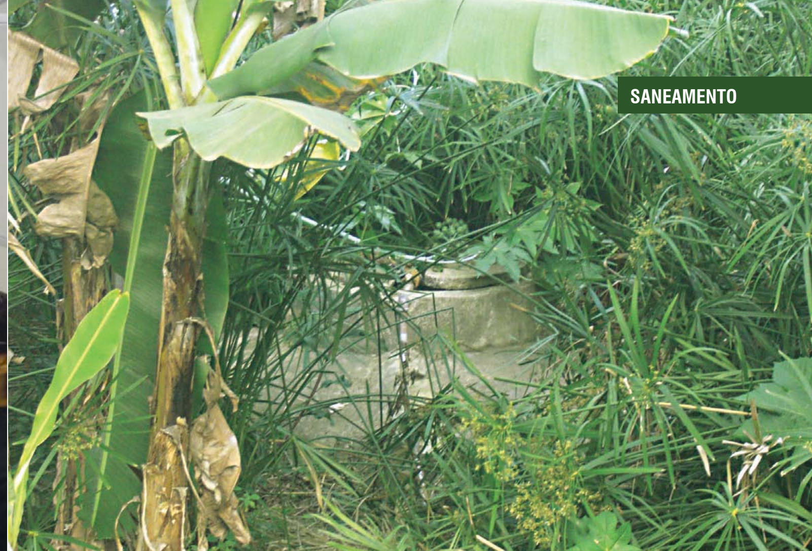
Biodigestor em funcionamento na comunidade Várzea do Inhame (Lídice), Município de Rio Claro (RJ)
